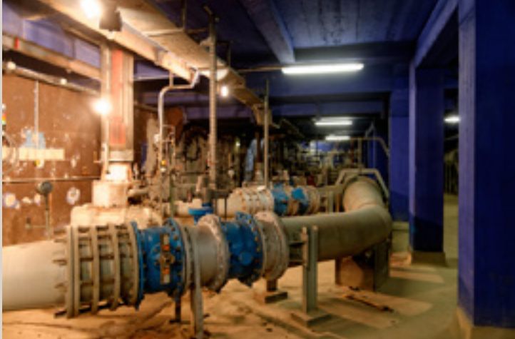
Vue de la salle des machines dans les sous-sols de l'usine B.
