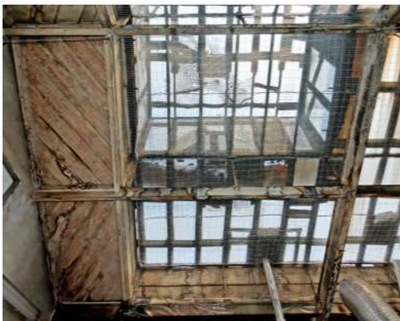
Ci-contre : vues d'ensemble et détail de la charpente dont la conservation est demandée.
