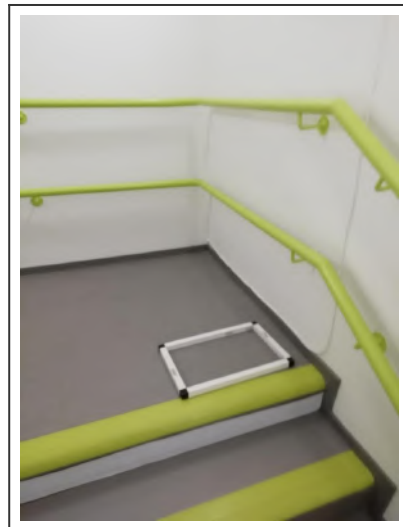
4 - R+2 à R+3 - Volée d'escalier - Sol
