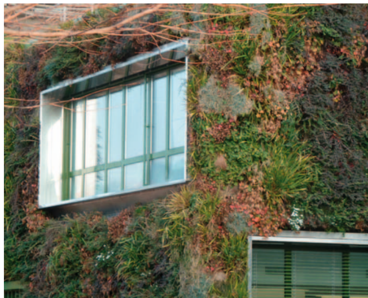
Mur végétalisé école polyvalente, rue buffet (17 e ). © S. Tabillon
