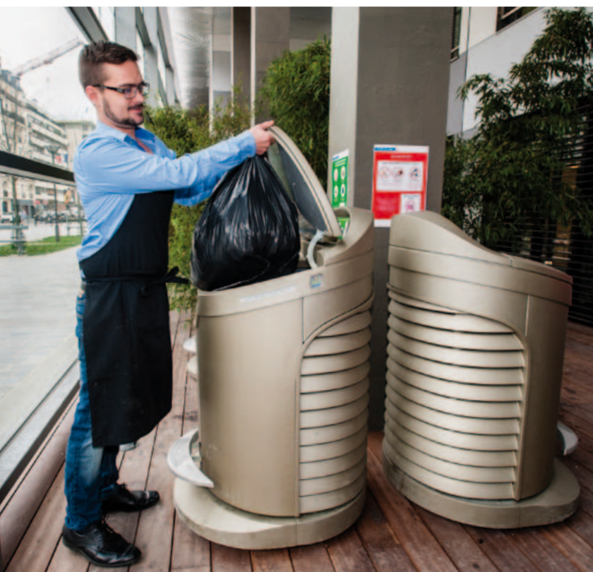
Collecte pneumatique des déchets (17 e ). © E. Chaix
