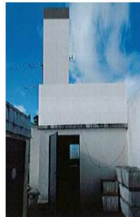
EMPLACEMENT DES ANTENNES APRES TRAVAUX
