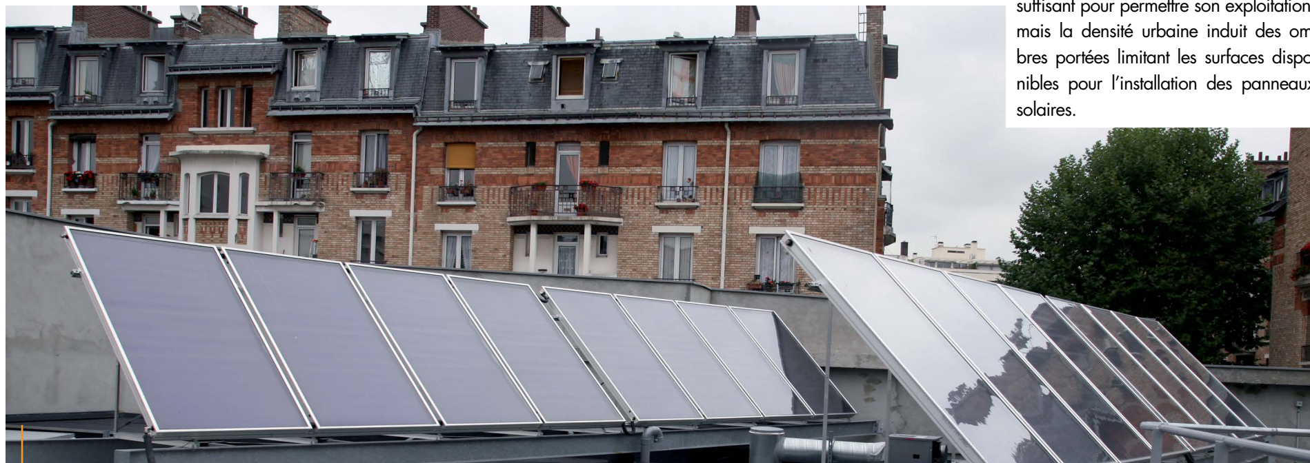
Panneaux solaires thermiques, Paris 12 e
