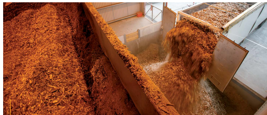
Chaufferie biomasse au bois
