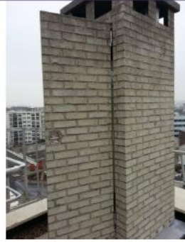
PHOTO ANTENNES AZ. 0° AVANT TRAVAUX
