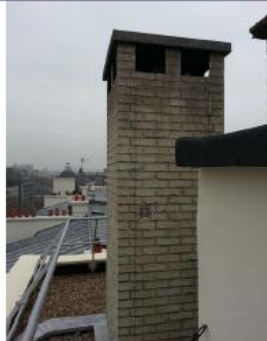
PHOTO ANTENNES AZ. 160° /260° AVANT TRAVAUX
