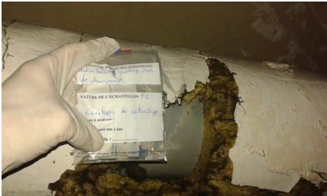
P2 - Station service 1 - Conduit - Enveloppe de calorifuge
