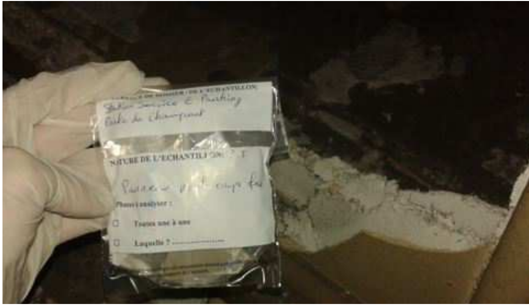
P3 - Station service 2 - Porte coupe-feu - Panneau porte coupe feu
