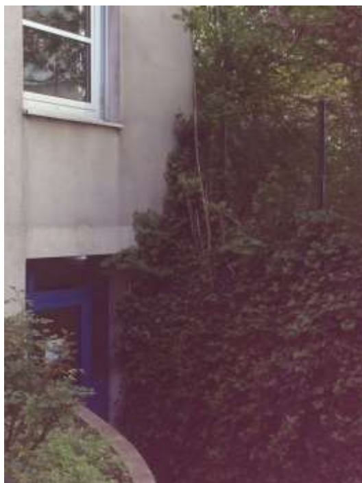
Photographie 6 : Entrée du garage à poussettes installé dans le dégagement de la sortie de secours du sous-sol.
