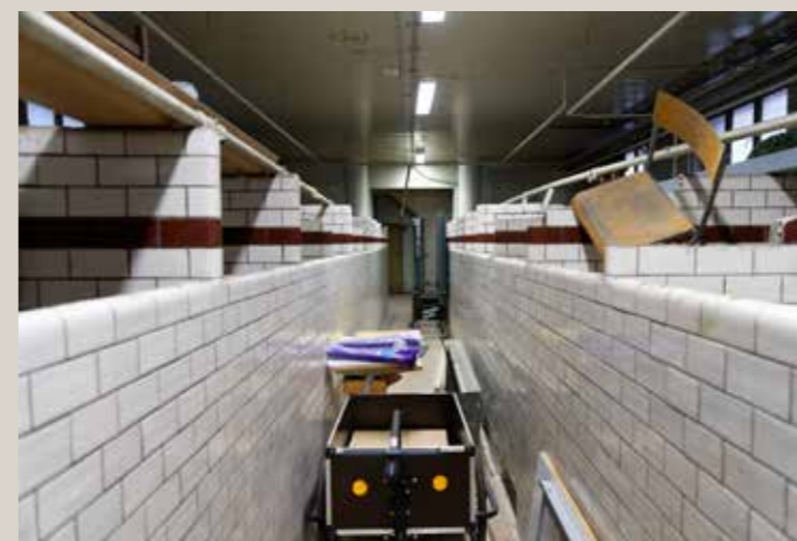
Vue actuelle de l'enfilade de douches de part et d'autre d'un couloir central.
