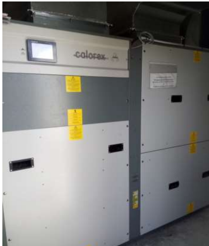
12. Armoire de gestion technique de la CTA du bassin mobile.
