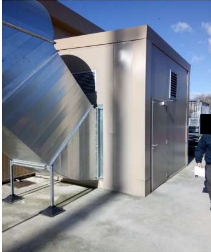
11. Vue extérieure de la centrale de traitement d'air (CTA) du bassin mobile avec le conduit d'extraction à gauche.
