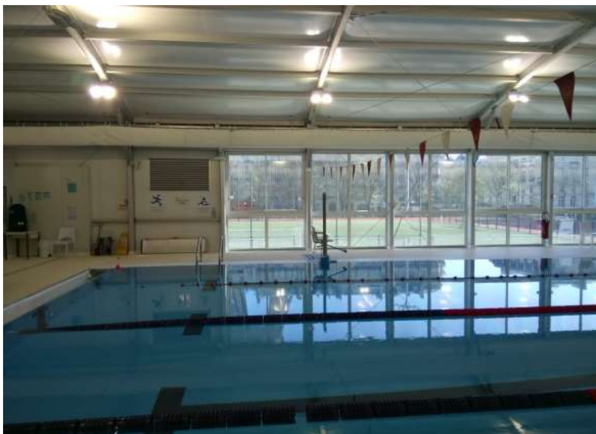
10. Vue de la gaine de soufflage en partie haute côté stade et de la grille d'extraction d'air à gauche de la baie vitrée.
