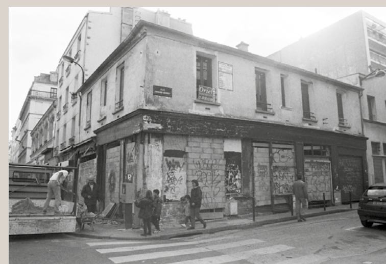
Vue de l'immeuble en août 1998, après incendie.
