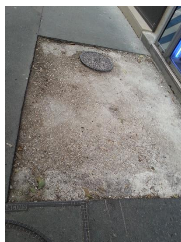
Au 61 Avenue Parmentier ,présence siège sur le trottoir -67 Dénivellement de la chaussée endommagements du trottoir suite à travaux -risques de chutes
