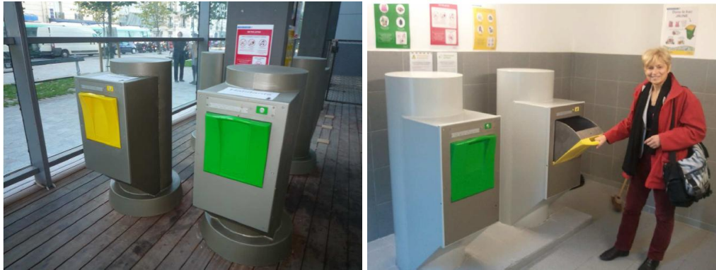
Figure 2 – le système de collecte pneumatique des déchets
