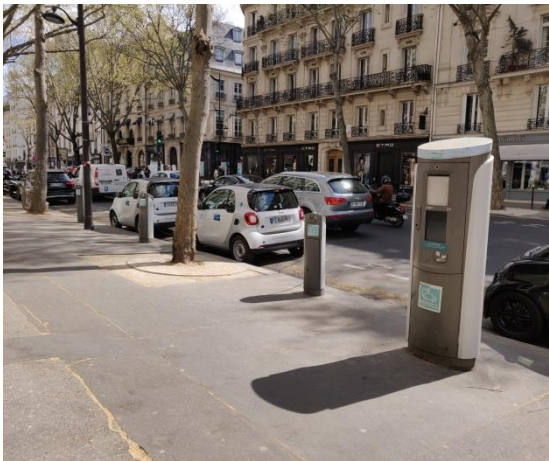
Bornes de recharges électriques – Boulevard St-Germain
