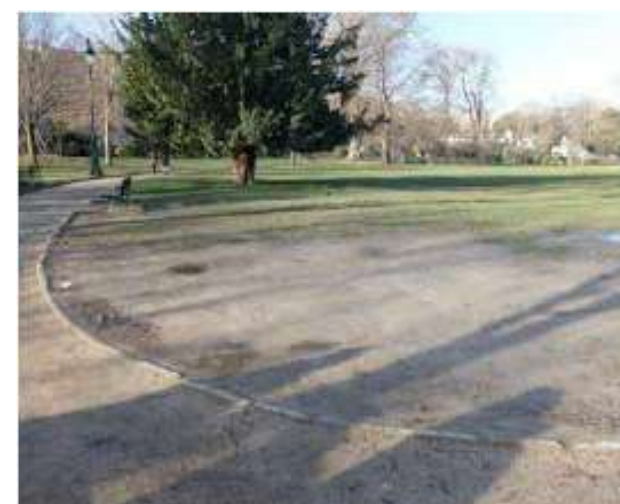
Tassement du sol près de la tour Eiffel, débordement des allées et traversées sauvages des pelouses.
