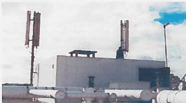
Exemple d'antennes existantes.
