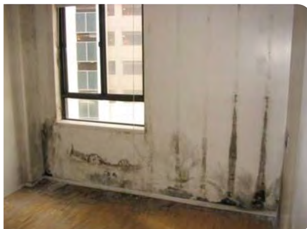
Condensation sur le mur de façade derrière le papier peint
