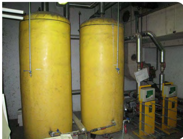
Production d'eau chaude sanitaire : ballons et échangeurs à plaques
