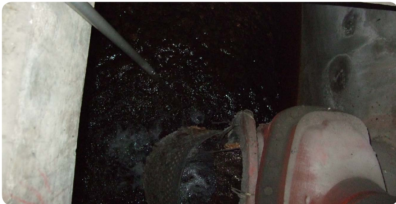
Cuve de récupération des eaux d'exhaure
