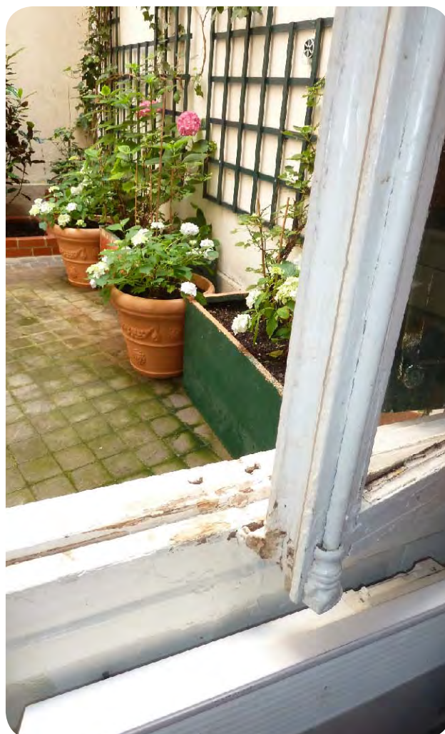
Peinture dégradée contenant du plomb
