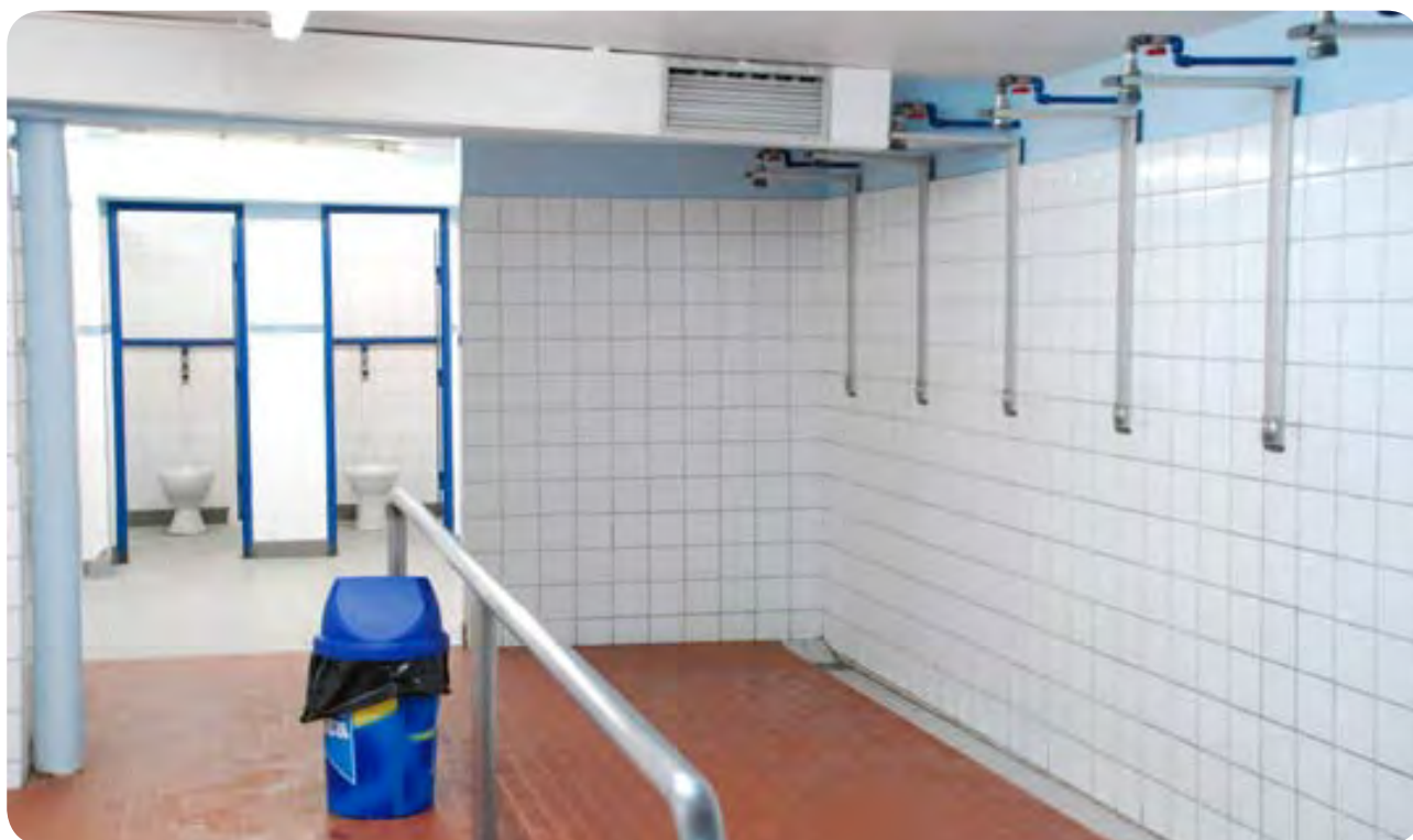
Douches d'une piscine
