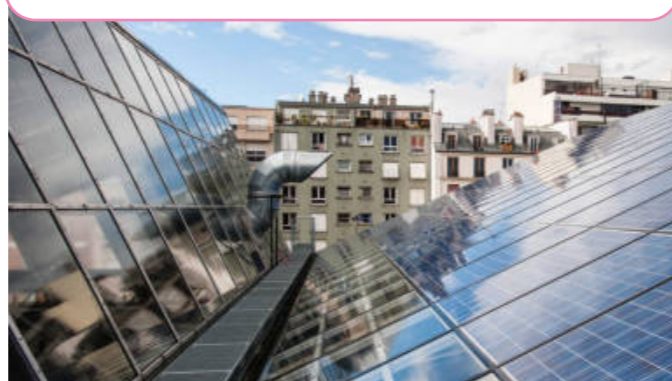
Lauréat du Budget participatif, ce projet vise à produire de l'électricité ou de l'eau chaude de façon écologique et économique, afin de contribuer à lutter contre la précarité énergétique dans les quartiers populaires. Il s'est concrétisé en 2022 avec l'installation de panneaux solaires sur les toits de deux établissements scolaires (Lamoricière 12 e , Elsa Triolet 13 e ) et des logements sociaux Elogie Siemp dans le 20 e arrondissement.
