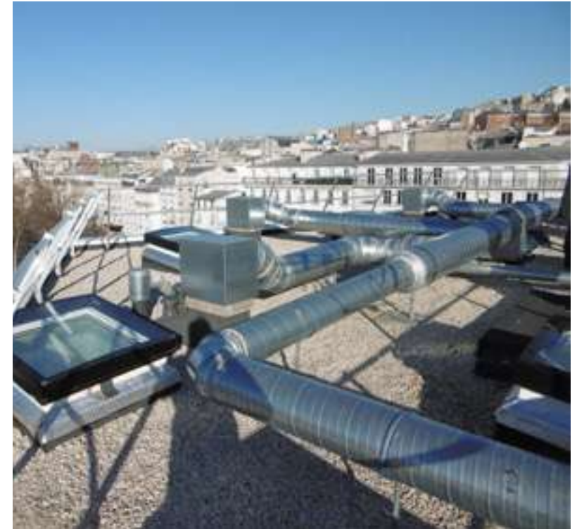
Toiture-terrasse avec nouvelle installation de ventilation
