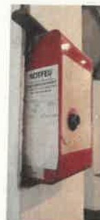
Commande de désenfumage
