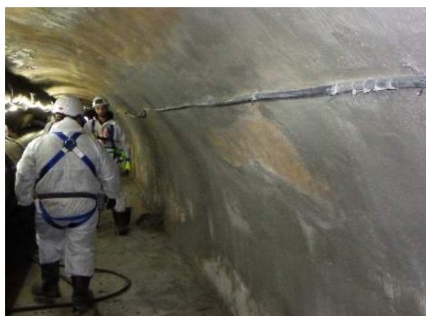
(Haut) Galerie rue Tardieu et (Bas) Galerie place d'Italie - reprises de maçonnerie
