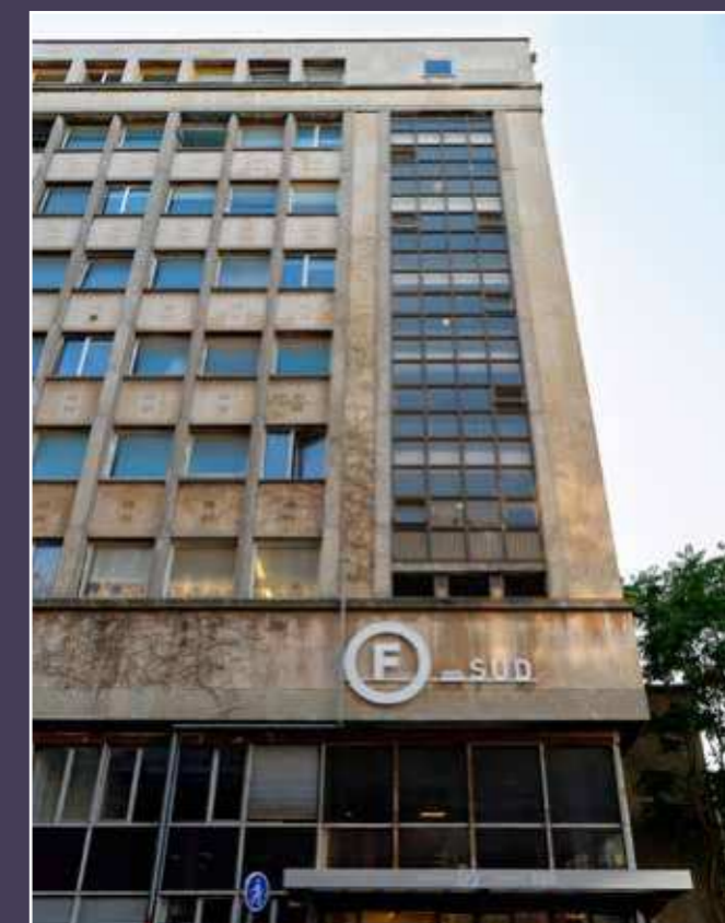
Vue rapprochée de la travée de l'escalier dont la démolition est demandée, 2016 (© Christian Rapa).
