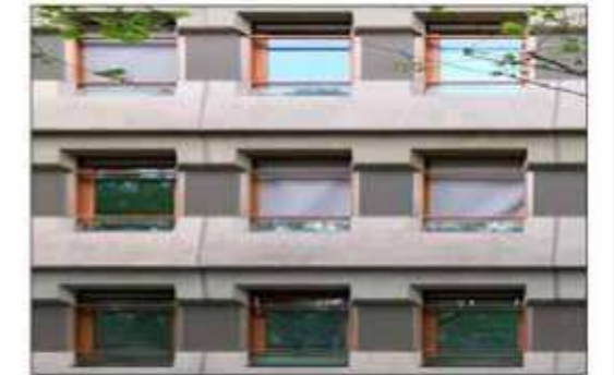
62 RUE DE MOUZAÏA CRÉNELAGE DES BANDEAUX D'ETAGE, DILATÉS
