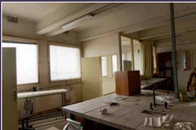
Vue actuelle d'un laboratoire et des allèges dont la démolition est demandée.
