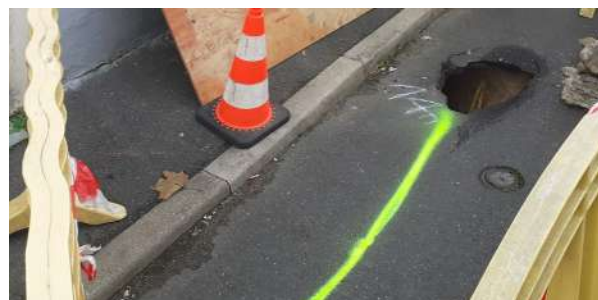
Trou de 14m de profondeur suite à déboussage de puits dans une rue de Bagneux
