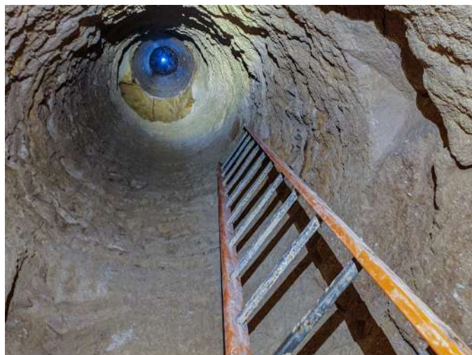
Perois d'un ancien puits en partie effondrés dans une propriété privée à Paris 14 e
