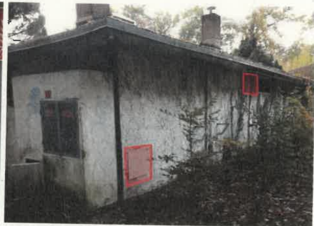
Emplacements des ventilations basse haute du local chaufferie
