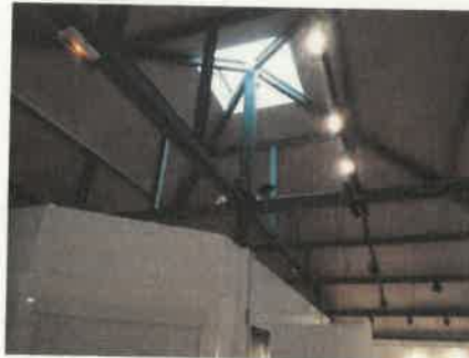
Vue intérieure de l'ouvrant de désenfumage au faitage
