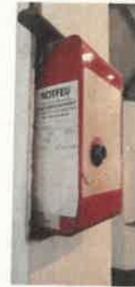
Commande de désenfumage
