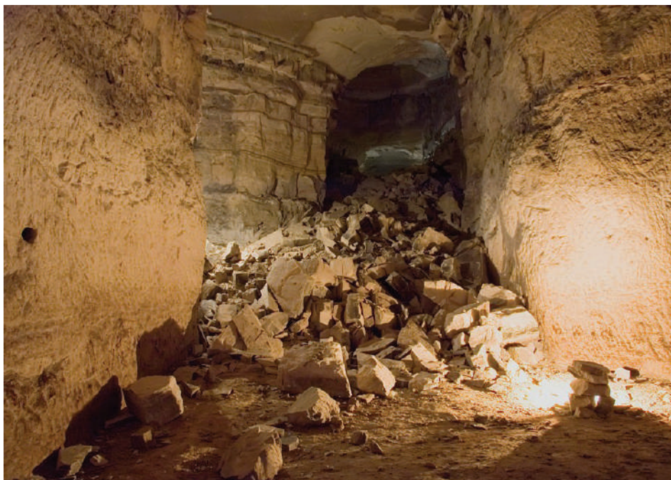
Fontis dans une carrière de gypse
