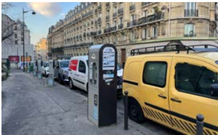
Station de recharge électrique Rue Jeanne d'Arc
