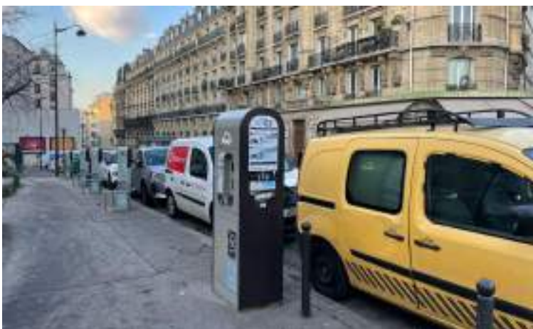
Station de recharge électrique Rue Jeanne d'Arc
