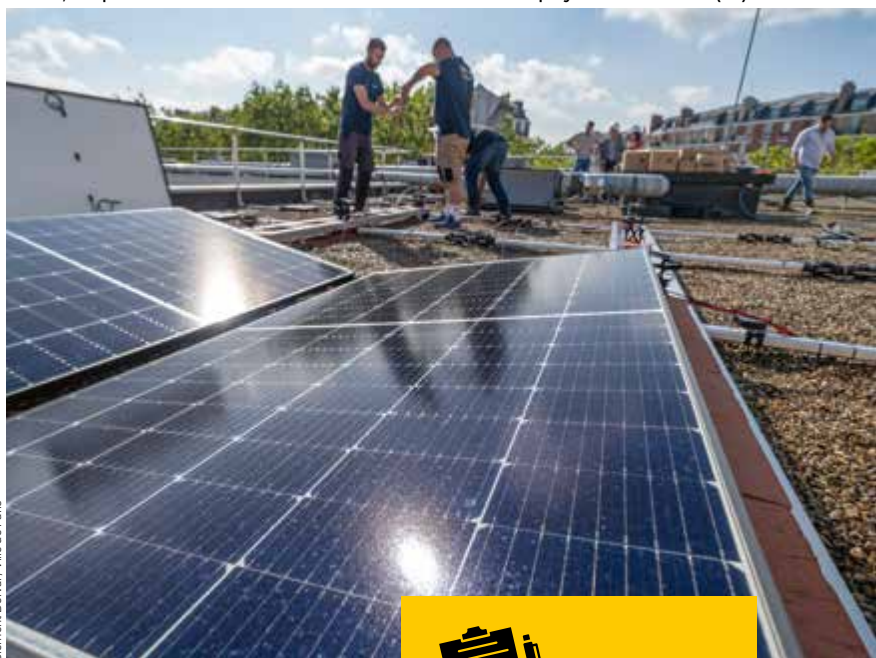
Cet été, des panneaux solaires ont été installés sur le toit de l'école polyvalente de Reims (17 e ).
