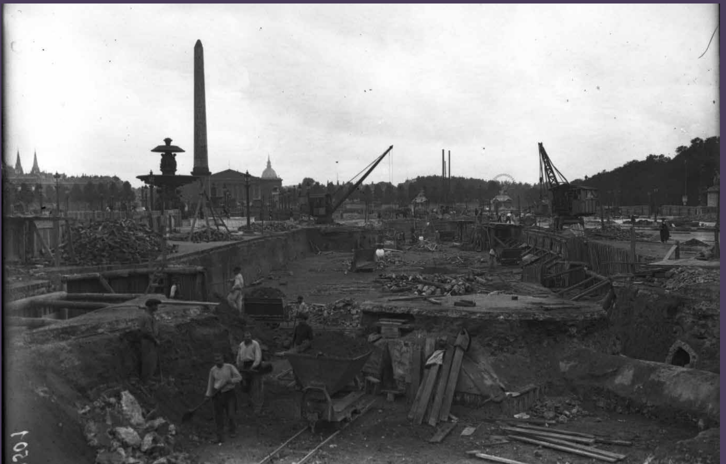
21d. Vue des terrassements lors de la construction de la ligne 8 du métropolitain, Agence Rol, 1908 - BnF
