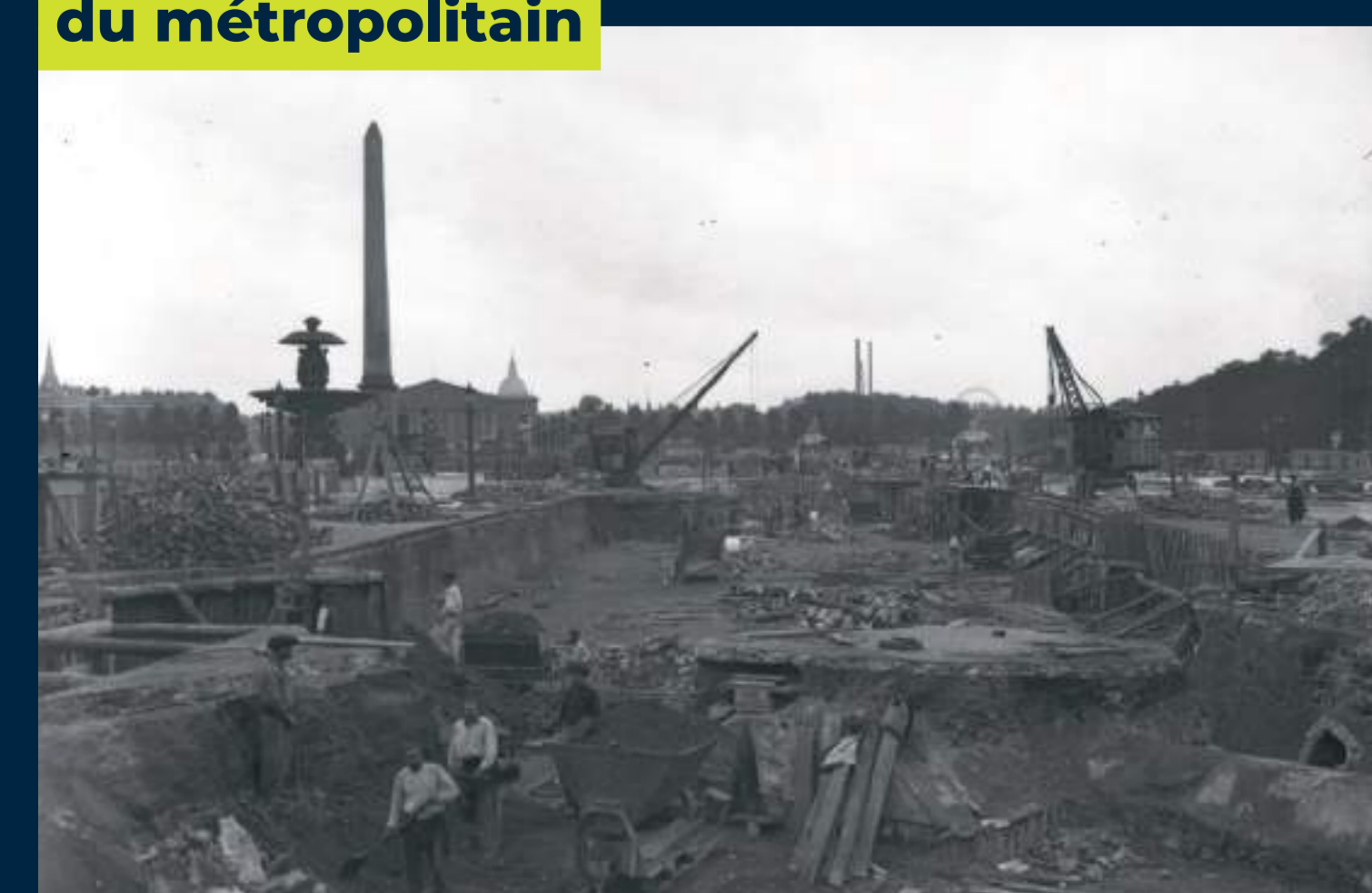
Vue des terrassements lors de la construction de la ligne 8 du métropolitain
