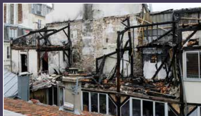
Vue de l'aile des ateliers qui ont brûlé en mai 2019 (© DHAAP / ML).
