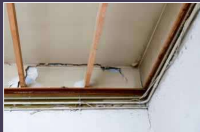
Lézardes à l'intérieur du bâtiment à R+2 dont la démolition est souhaitée dans la faisabilité.
