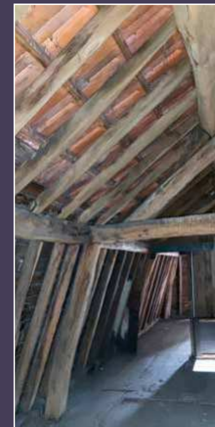
Vue actuelle des combles du bâtiment à R+2 dont la démolition est souhaitée.
