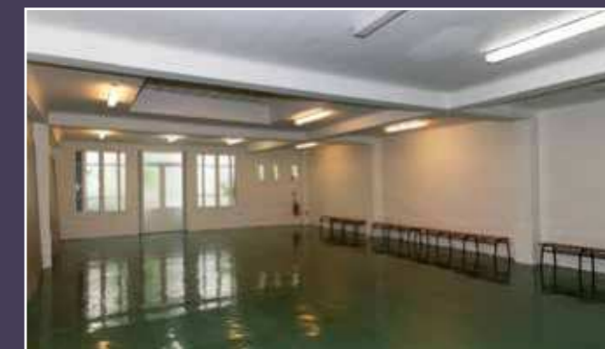
Vue actuelle de la grande salle dans le bâtiment B construit en béton armé entre 1968 et 1976.
