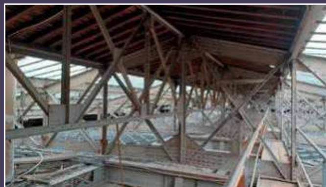
Gare des Invalides, vue sur la charpente métallique de la grande verrière centrale, 2022 (S. Texier).
