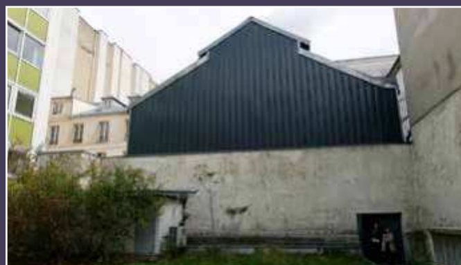
Vue actuelle du pignon aveugle de la halle, recouvert d'un bardage contemporain.
