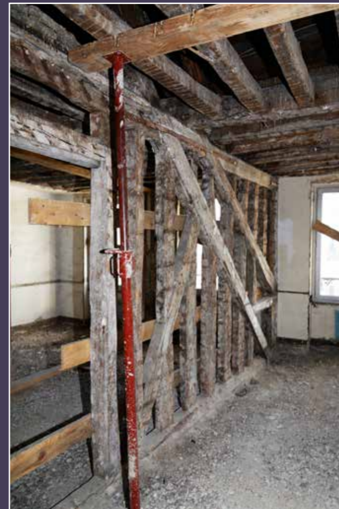
Vue du curage en cours et des arbalétriers qui témoignent des redressements de combles, 2024 (© DHAAP / MI).
