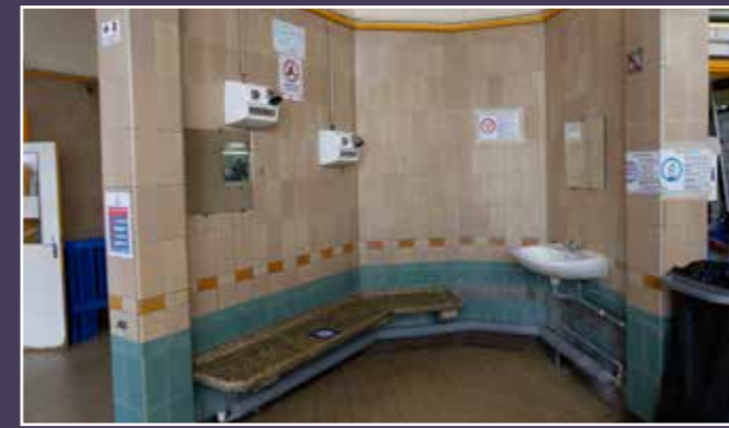
Vue d'un espace beauté, ses éléments d'origine et ses dégradations, 2023 (© DHAAP / PS).
