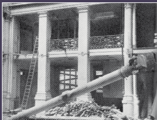
Vue de l'immeuble pendant les travaux d'André Lestang, photographies publiées dans La Banque , n°27, 1962 (Archives de la Banque de France).
