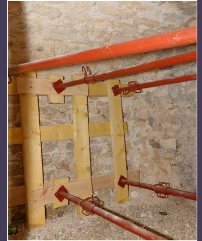
Vue du confortement en sous-sol (© Projedia).
