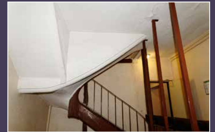
Vue de la dernière volée de l'escalier menant au R+5, dont la démolition est demandée, 2024 (© DHAAP / ML).
