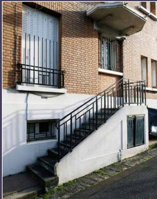
Vue de l'accès secondaire condamné, 2024 (© DHAAP / ML).
