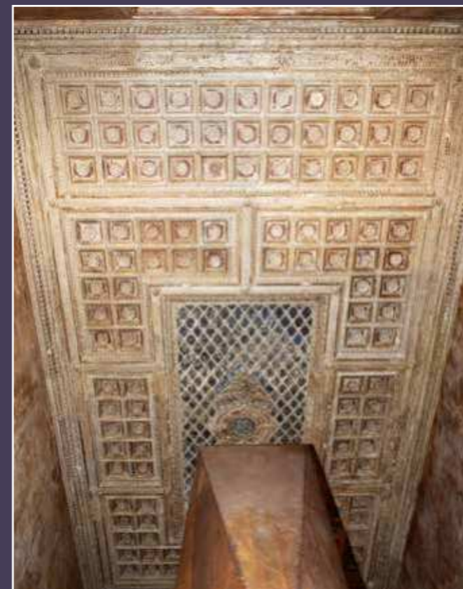
Vue du plafond de la cage d'escalier avec insertion de l'ascenseur, 2024 (© DHAAP / ML)
