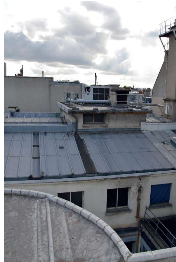
Les équipements techniques en toiture
