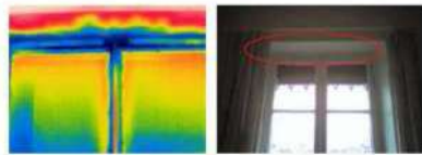
Défaut d'étanchéité sur les menuiseries
