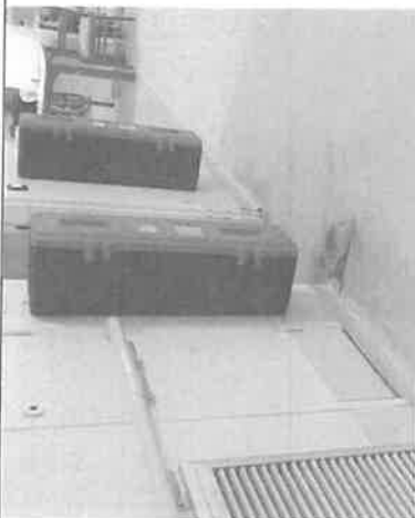
Photo n° 19 : revêtement de sol endommagé et sale
