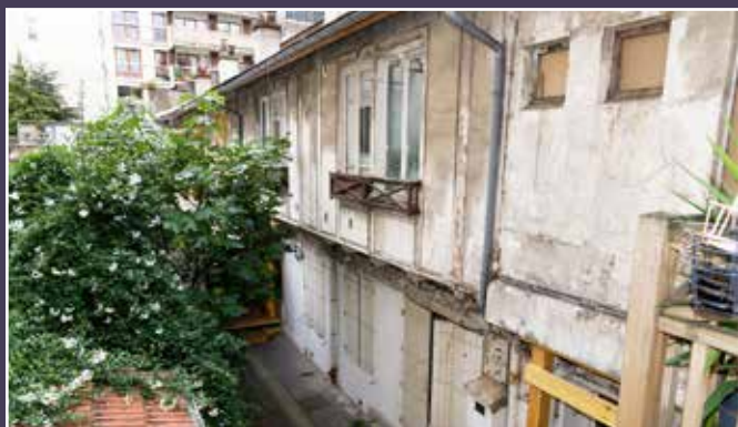
Vue de l'aile élevée le long d'un mitoyen où se situent le plus gros des désordres structurels, 2024 (© DHAAP / ML).
