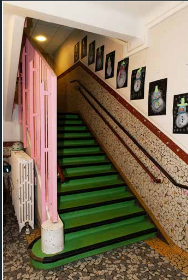
Exemple de décors à carreaux cassés dans les cages d'escaliers a priori conservés, 2024 (© DHAAP / ML).
