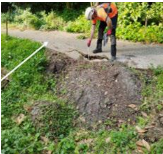
Glissement de terrain devant la grotte
