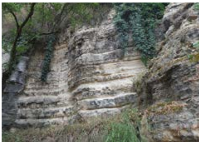
Falaise naturelle où du béton a été injecté pour colmater les fissures de l'île ©Mairie de Paris, Sophie Tabillon
