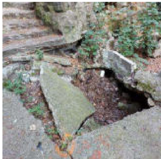
Éboulement et effondrement devant la cascade de la rivière Manin
