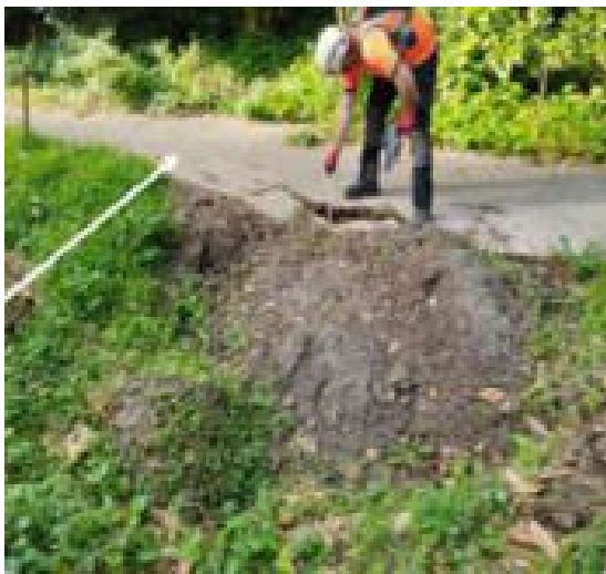
Glissement de terrain devant la grotte
