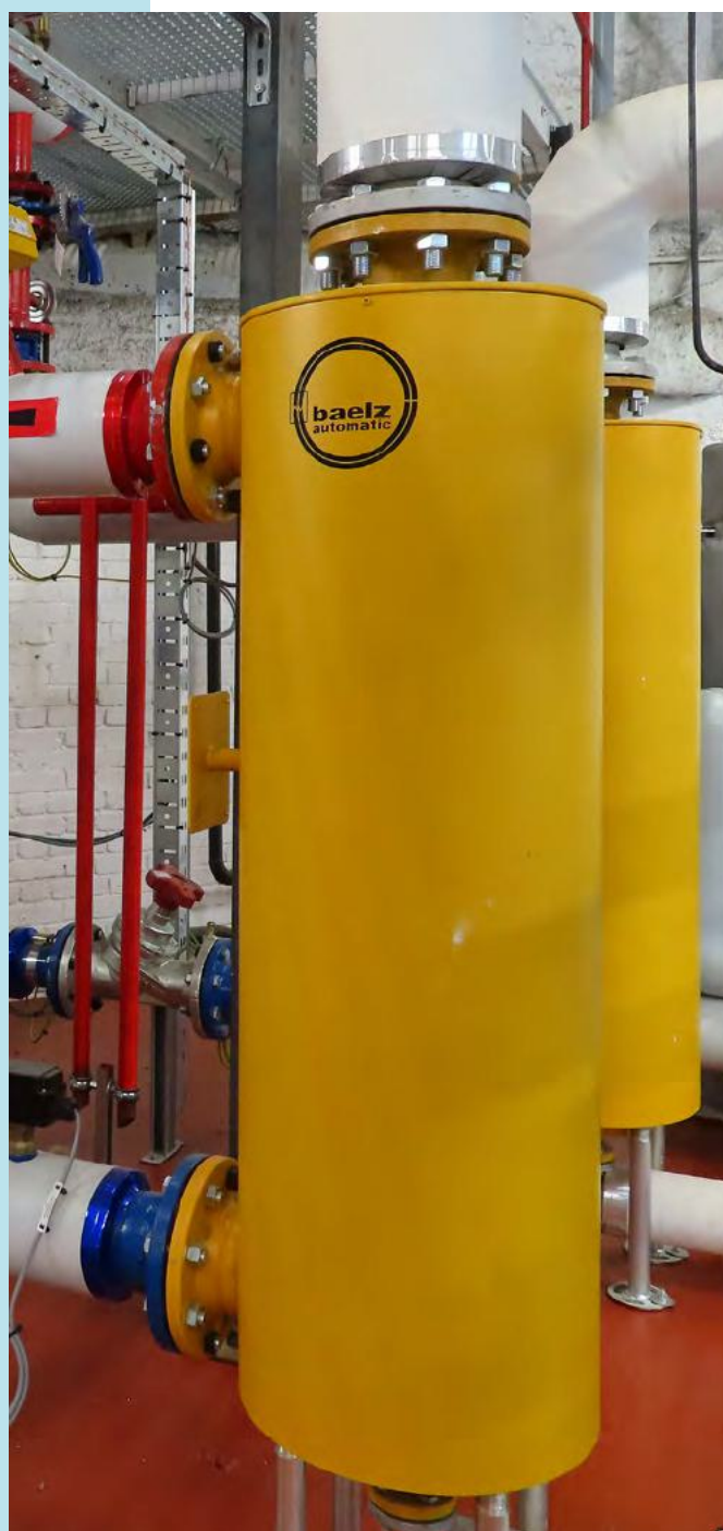
Chaufferie Mairie du 8 e @Cyril Abbas
