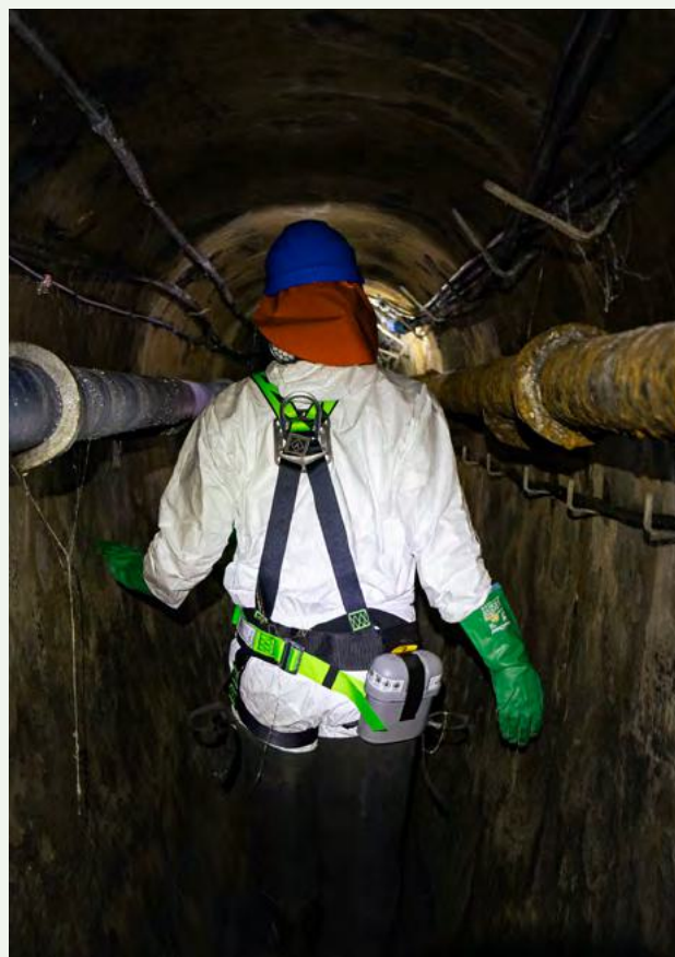
Réseau des égouts@Guillaume Bontemps
