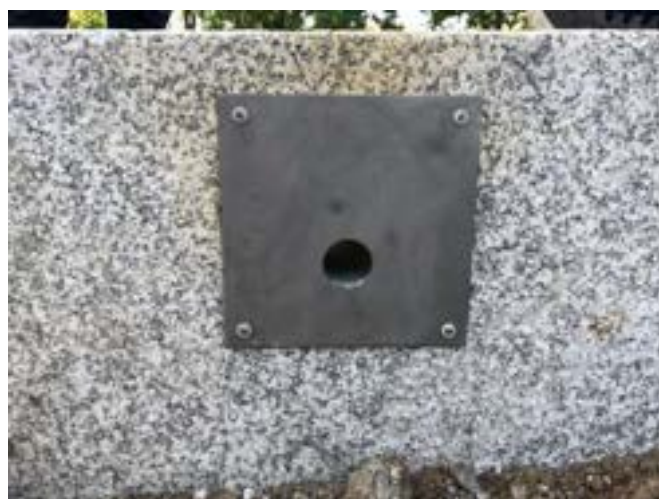
Plaque en inox avec un ajutage (orifice calibré) posée sur un muret de bief, Livry-Gargan (93)
