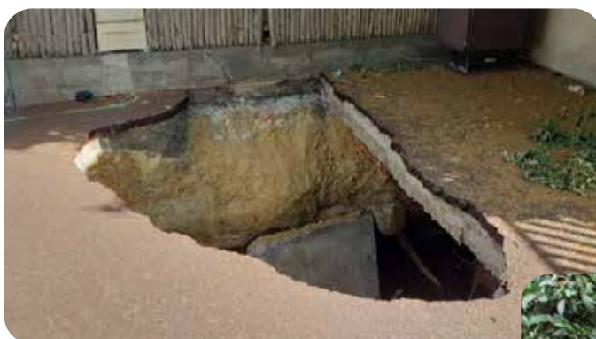
Effondrement à Suresnes
