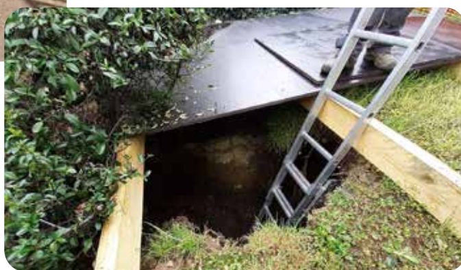
Effondrement à Ivry-sur-Seine
