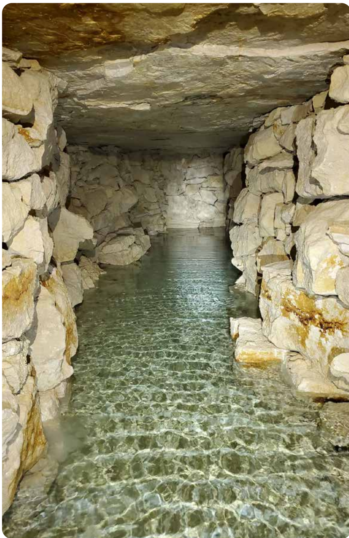
Galerie inondée à Bagneux
