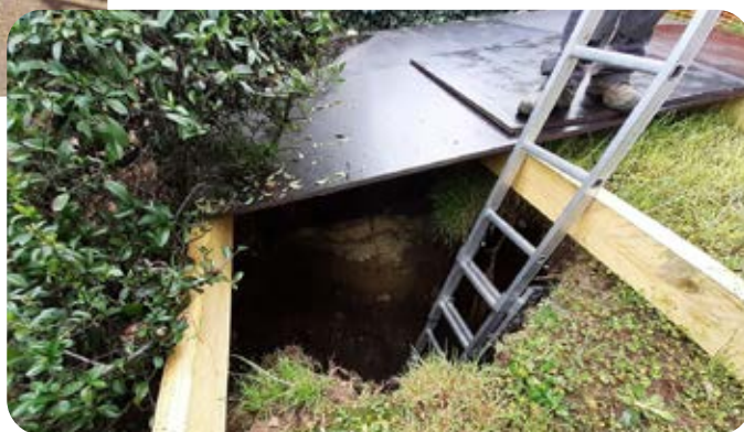
Effondrement à Ivry-sur-Seine
