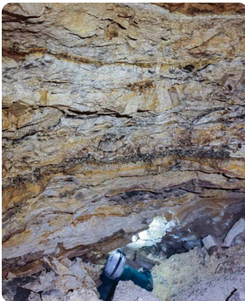
Découverte du fontis lors d'une visite d'inspection en carrière
