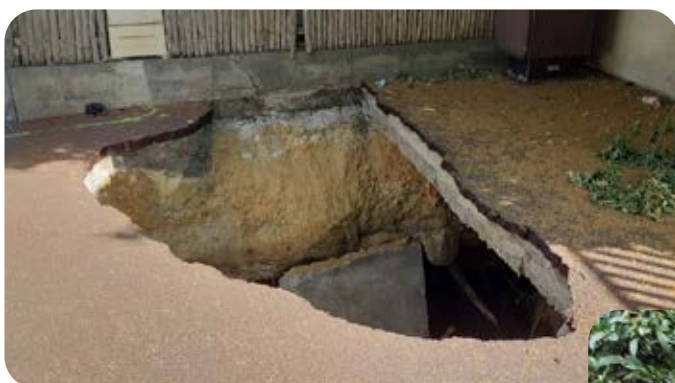
Effondrement à Suresnes
