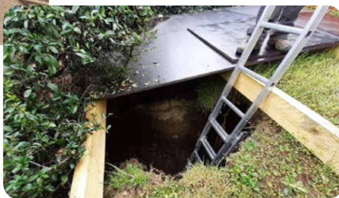
Effondrement à Ivry-sur-Seine
