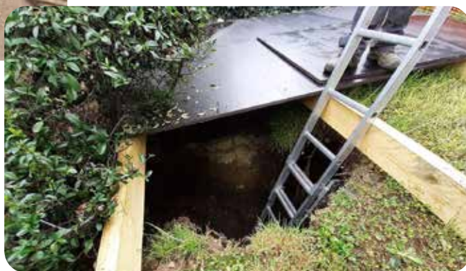
Effondrement à Ivry-sur-Seine
