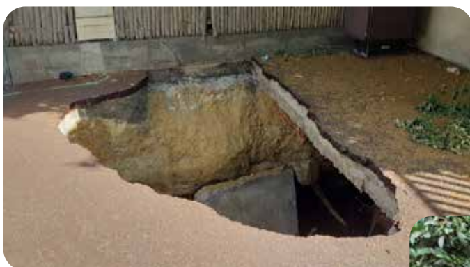
Effondrement à Suresnes
